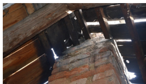
Požár od střešních latí.
