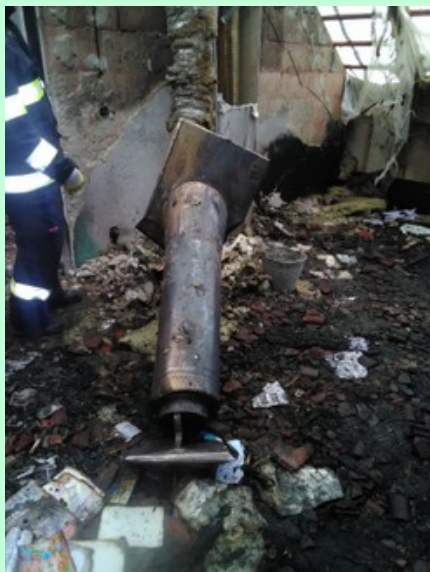
Stav spalinové cesty po uhašení požáru
