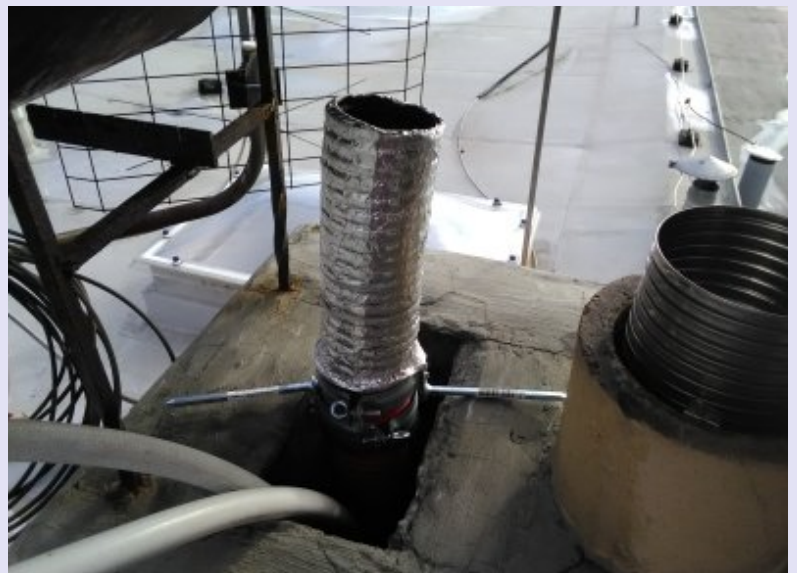
„Geniální“ provedení spalínové cesty z kabelové průchodky
