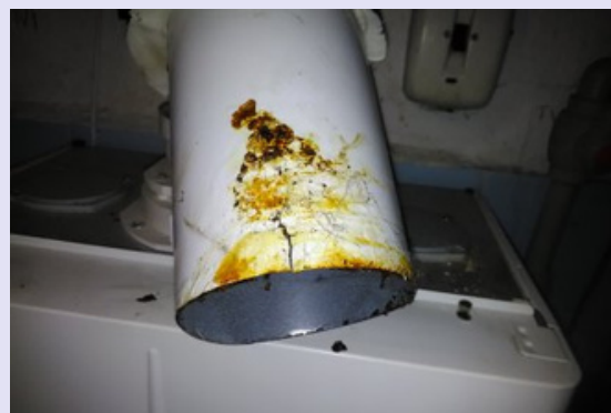
Koroze pláště SC
