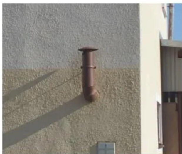
Do tohoto komína byl zapojen válcový ohřívač vody. Údajně řádně zkolaudován.
