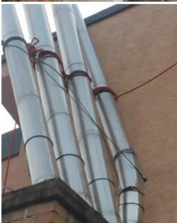
Také na tento komín byla vystavena revize.
