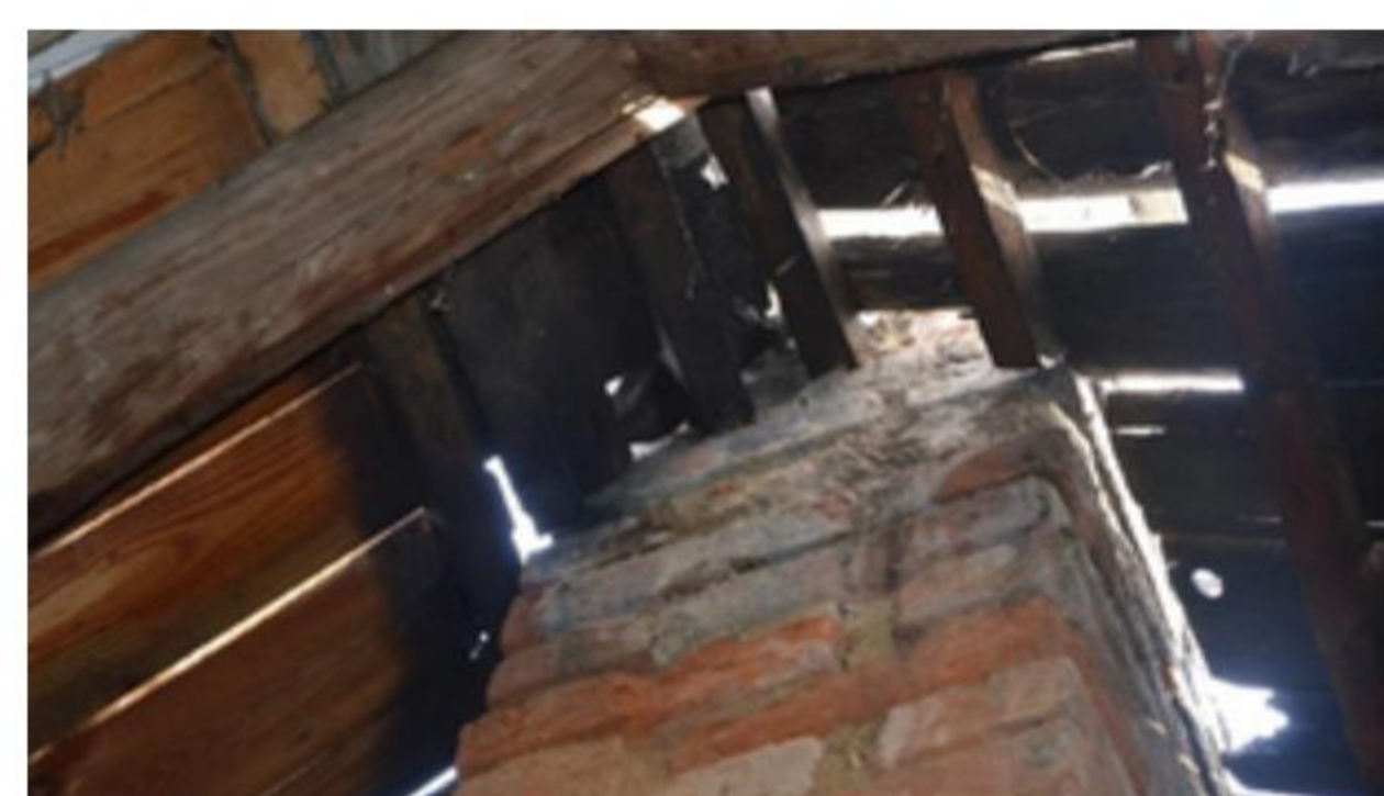
Požár od střešních latí.
