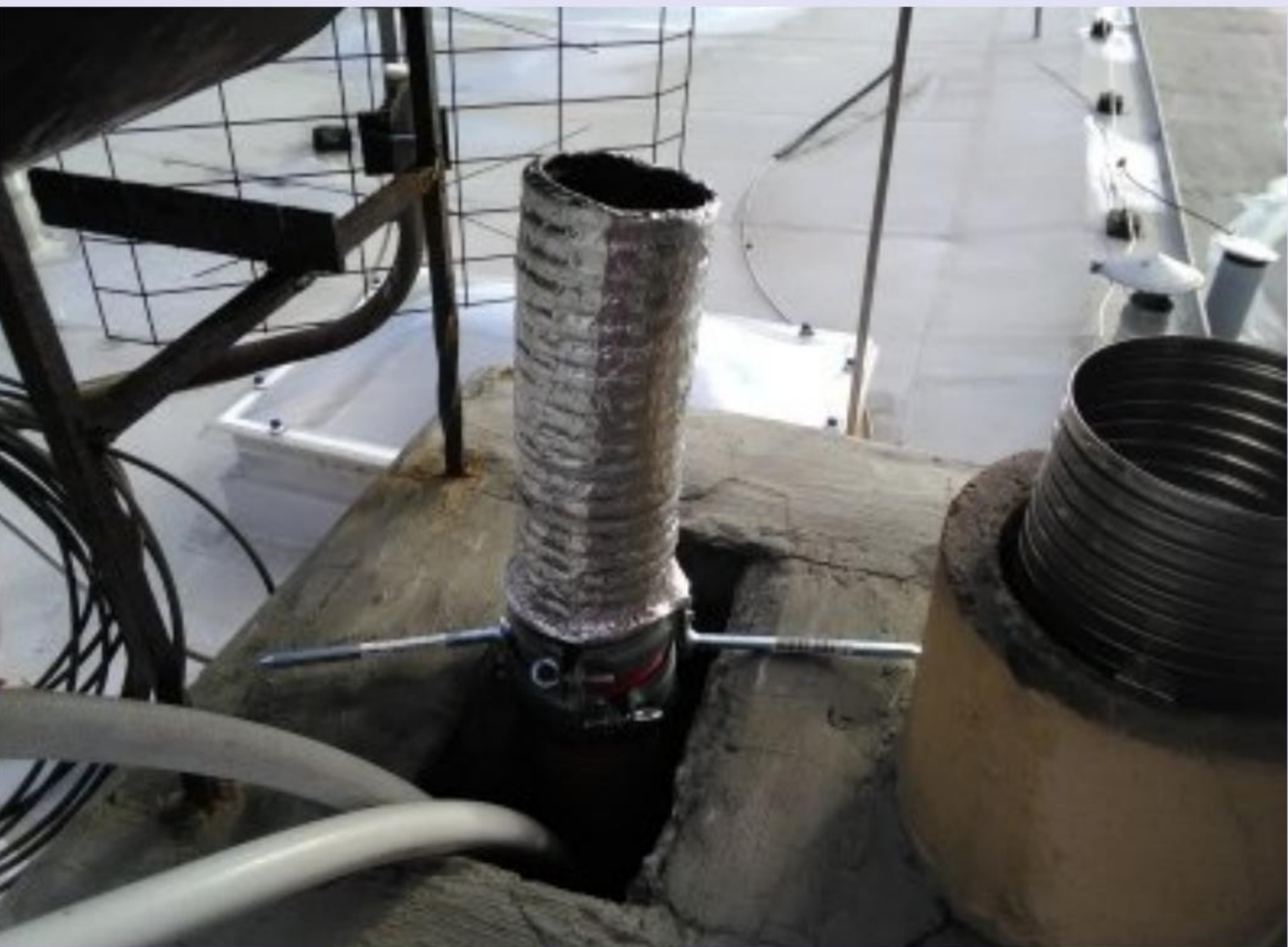
"Geniální" provedení spalínové cesty z kabelové průchodky
