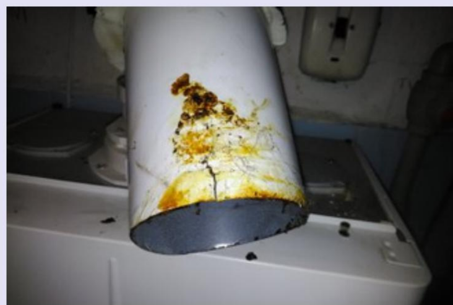
Koroze pláště SC
