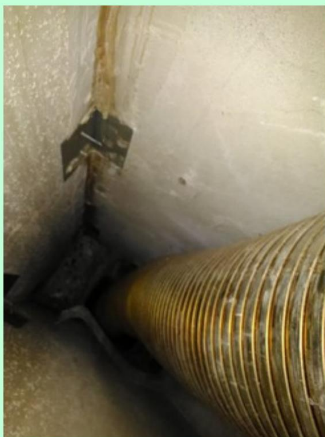
Pohled do teplovzdušné komory
