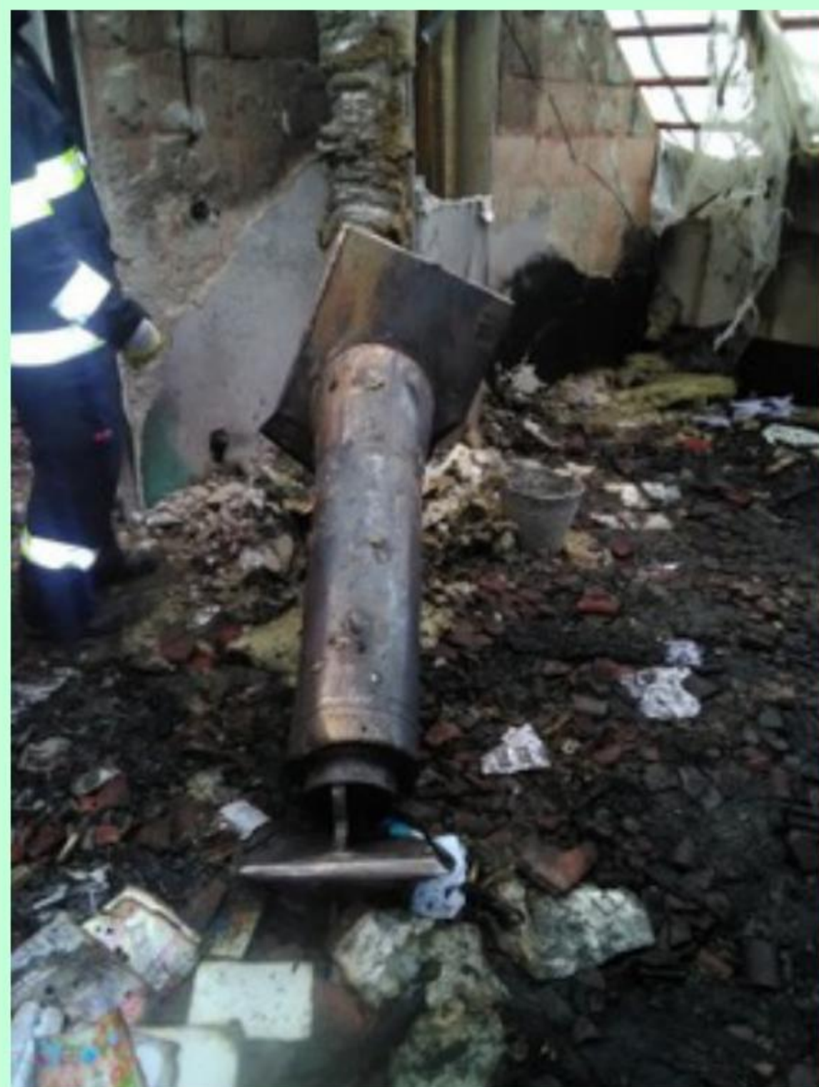
Stav spalinové cesty po uhašení požáru
