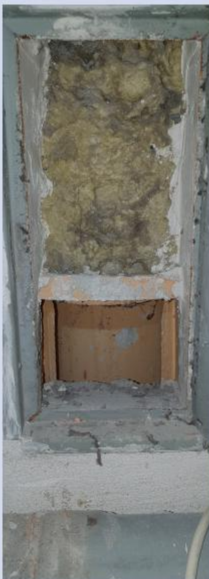
dvířka nesedí s vybíracím otvorem
