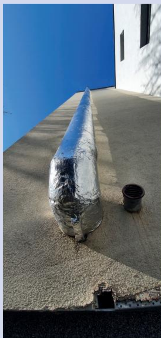
izolovaný plast jako 12m komín na bytovém domě
