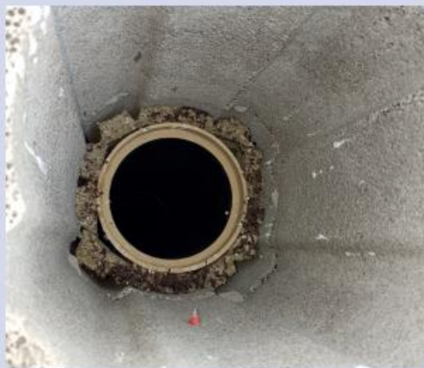
Schiedel, obrácená izolace, vrut zasahuje do vnitř pláště
