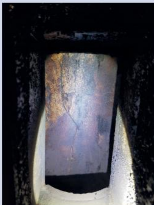
prasklá vložka v kontrolním otvoru
