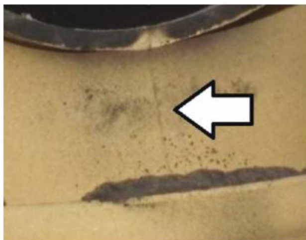
Prasklina na sopouchu systémového komína. Komplikovaným způsobem musel být sopouch opraven. Ve škole šlo o učení, zákazník by zaplatil několik tisícovek za opravu.
