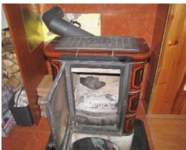
Poškozená vyzdívka, prohnuté hradítka roštové plochy, prohnutý ozdobný rošt, teplem odpadlý obklad za kouřovodem, hořlavá stěna ve směru sálání tepla z kouřovodu, vedle topidla složené palivo – brikety a dřevotřískas, vedle v koši zásoba „náhradního paliva“.
